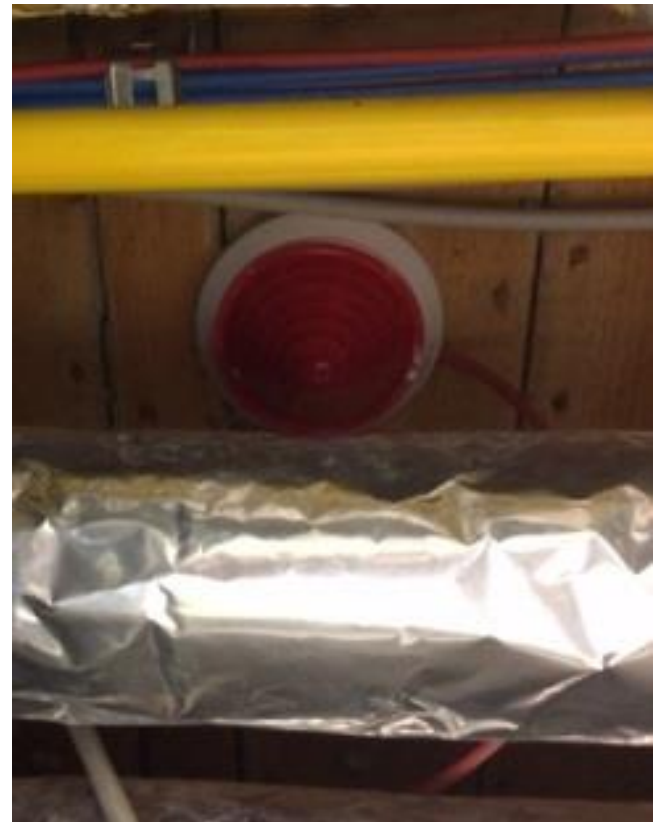
Abb. 22: Zwischendeckenmelder mit Staubschutzkappe während Bauarbeiten
